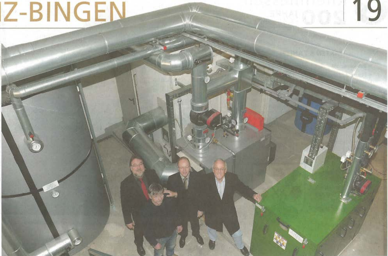
Am modernen Blockheizkraftwerk (grün): Christoph Zeis (v.l., Geschäftsführer EDG), Hausmeister Rolf Kobatschek, Erster Beigeordneter Thomas Glück und Ortsbürgermeister Thomas Becker-Theilig. Foto: hzb/Kristina Schäfer
