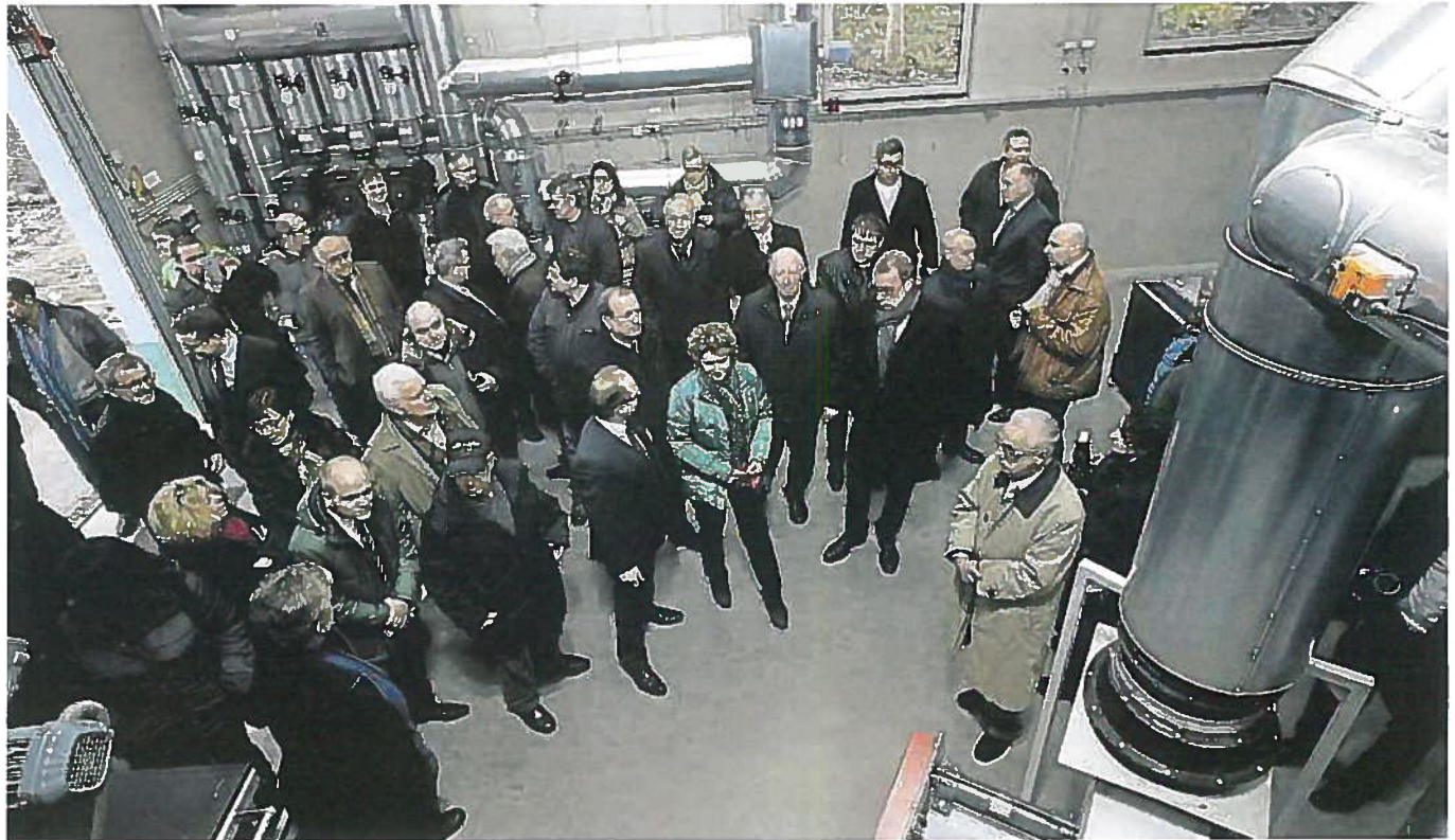
Blick ins Innere der neu gebauten Heizzentrale in der Brückener Straße: Bei der offiziellen Einweihung im Februar inspizierten die geladenen Besucher das Herzstück des nun mit einem bundesweit bedeutsamen Fachpreis ausgezeichneten Nahwärmenetzes in Birkenfeld. Foto/Archiv: Reiner Drumm
