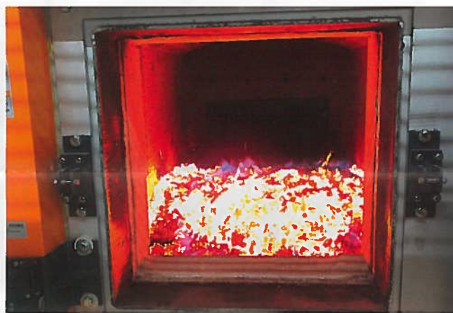
Feuerung in Nieder-Olm: 2019 um einen Hackschnitzelkessel ergänzt
