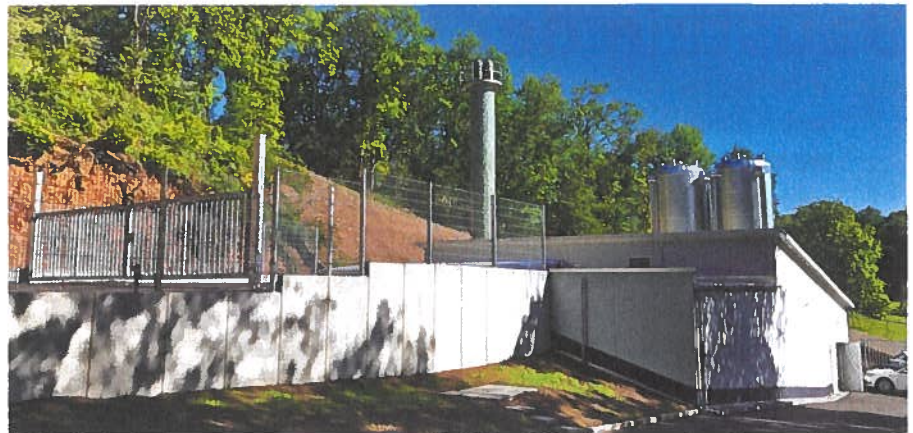
Heizzentrale der Bio-Solar-Nahwärmeversorgung Gimbweiler, errichtet und betrieben von der EDG Rheinhessen-Nahe.
